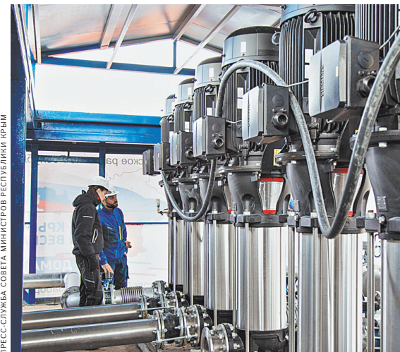
Бештерек-Зуйский водозабор вскоре будет ежедневно подавать в Симферополь 22 тысячи кубометров воды.
