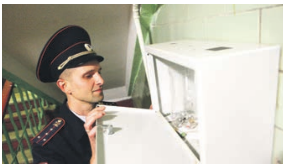
Вчера 21:10 Одесская улица, 17. Участковый Александр Потапович осматривает электрощиток в подъезде. Внутри — лишь бутылка со старыми батарейками
