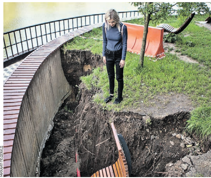
22 июня 2020 года 18:24 Жительница столицы Алиса Климова показывает провал грунта на набережной Шитова
