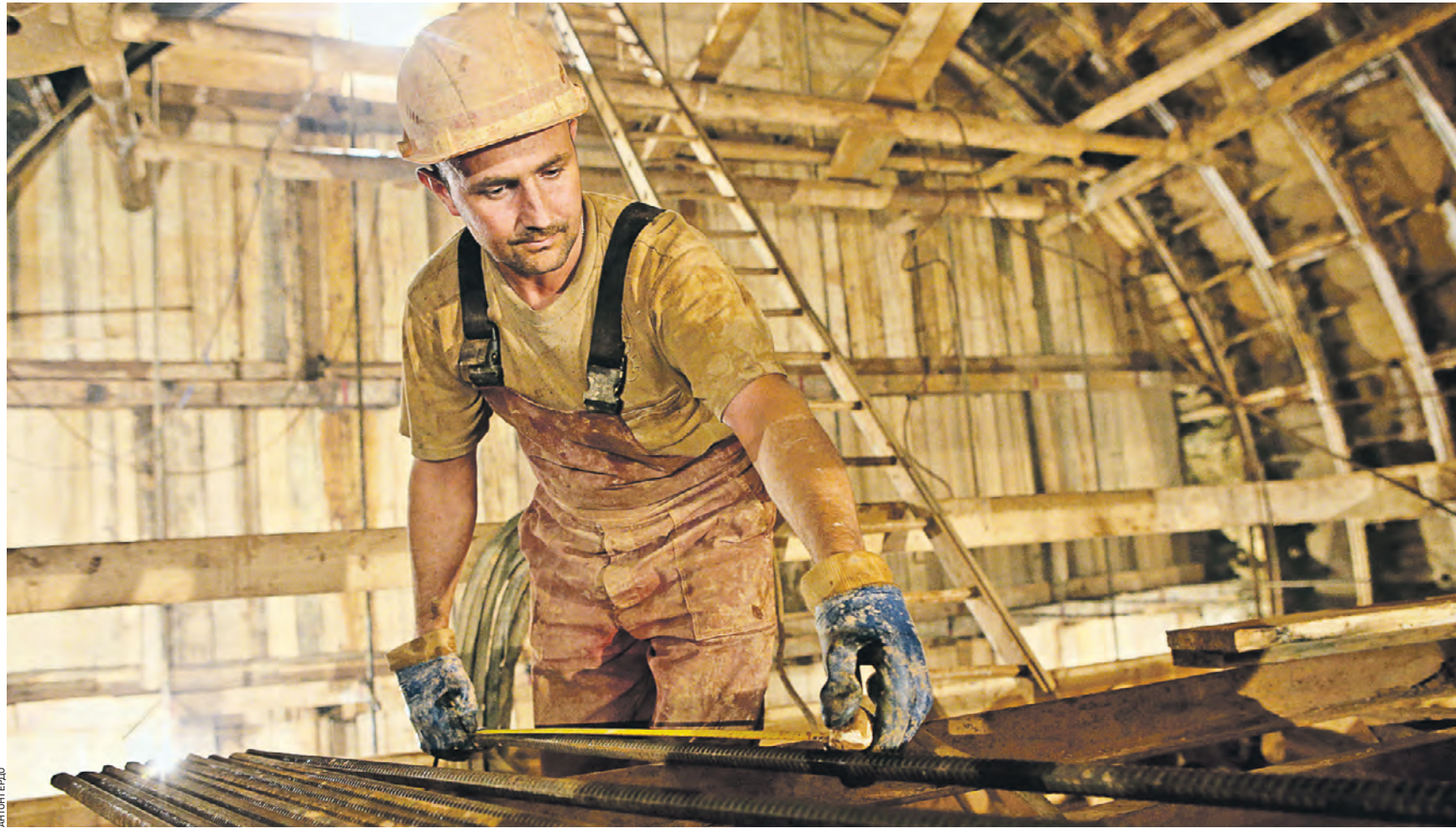
30 июля 2020 года. Проходчик строительно-монтажного управления № 6 Мосметростроя Николай Цыппов укладывает арматуру на станции «Рижская» Большой кольцевой линии метрополитена
